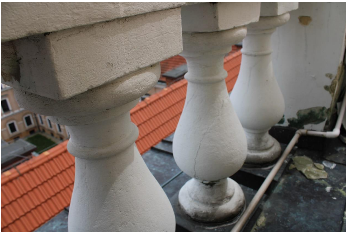
Fot. 20 Pęknięcia elementów
