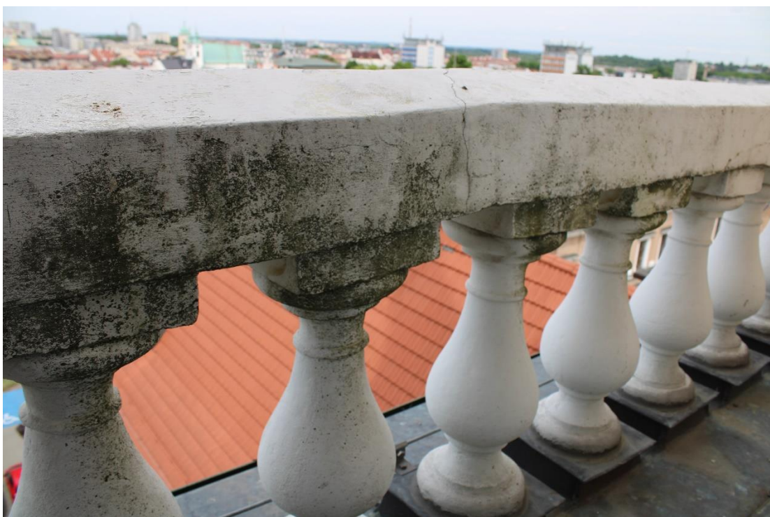
Fot. 23 Korozja biologiczna elementów
