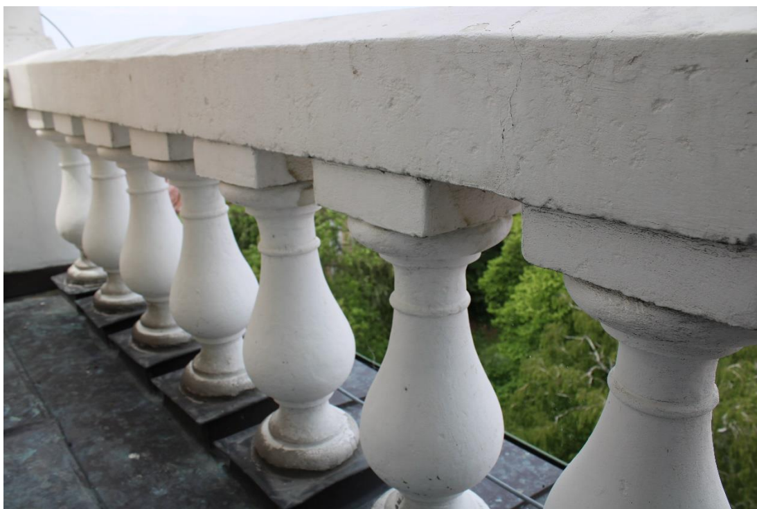
Fot. 32 Powierzchniowe pęknięcie poręczy od strony północnej
