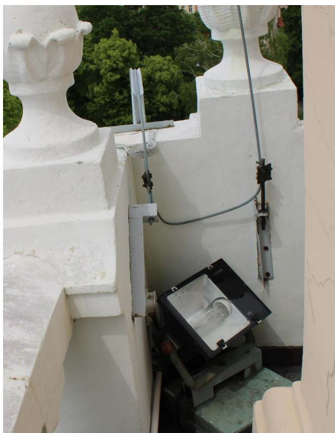
Fot. 18 Narożnik 4 -widok od strony balkonu
