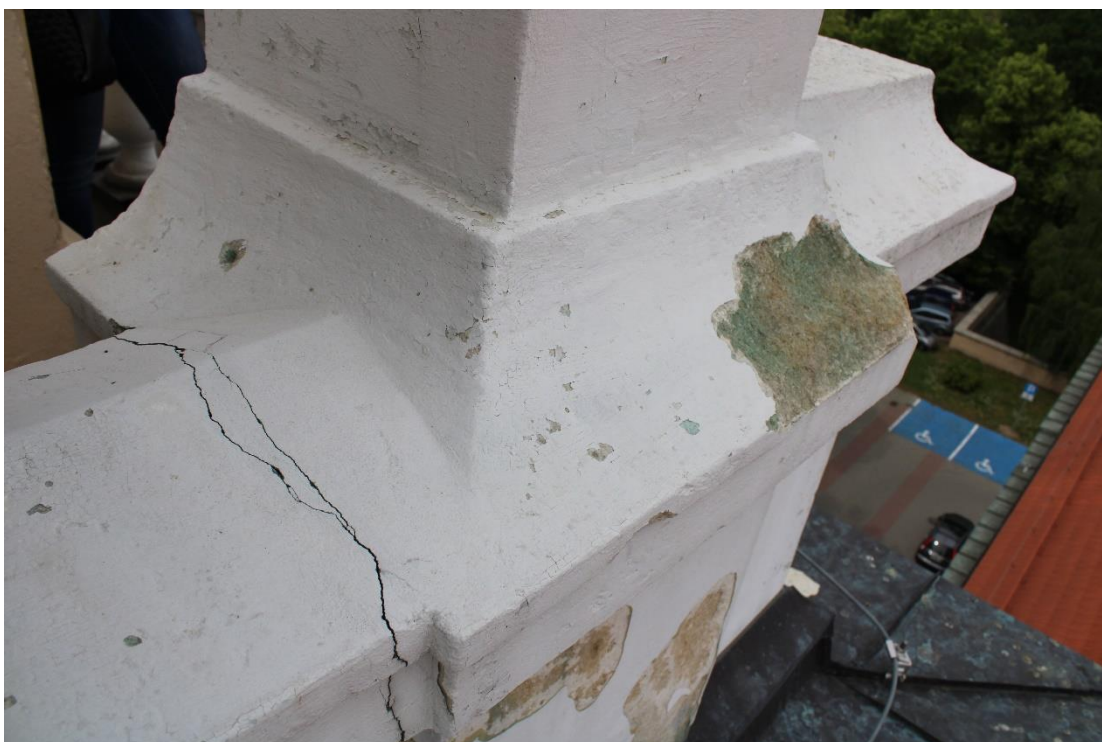
Fot. 26 Pęknięcie poręczy na styku z cokołem narożnym
