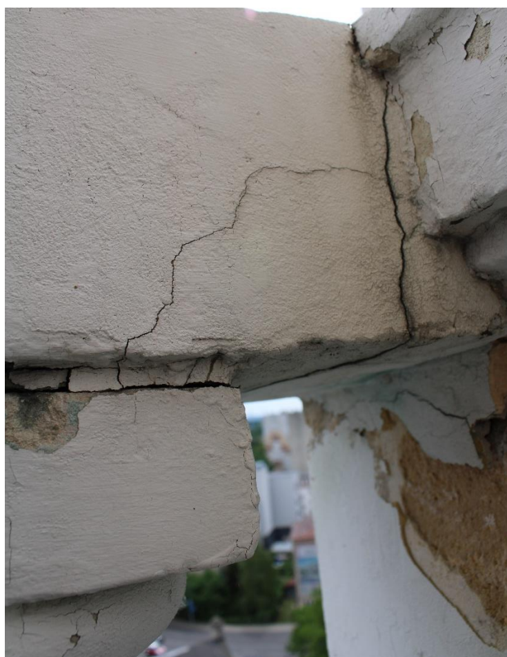
Fot. 28 Uszkodzenie dolnej części poręczy
