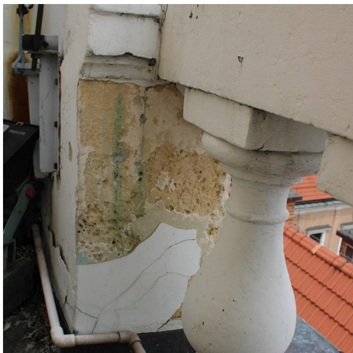
Fot. 9 Narożnik 1 -widok od strony balkonu
