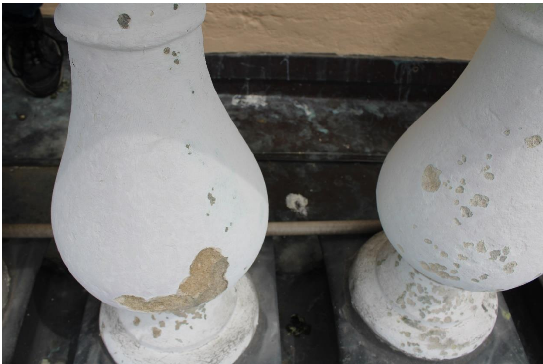
Fot. 22 Odspojenie powierzchni hydrofobizującej
