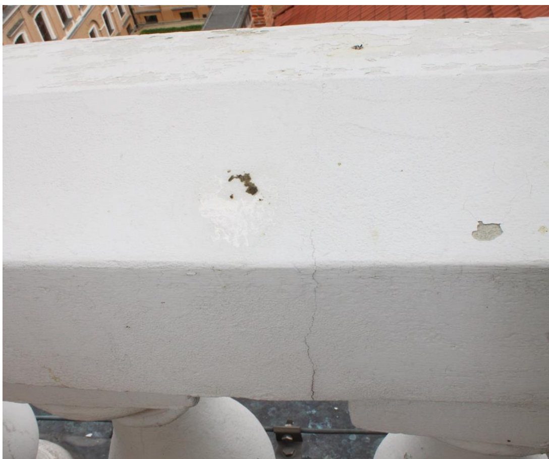
Fot. 30 Powierzchniowe pęknięcie poręczy od strony dziedzińca
