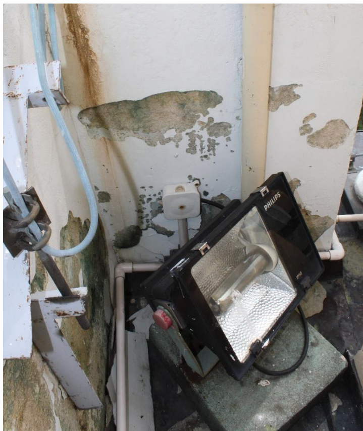
Fot. 11 Narożnik 2 – widok od strony balkonu
