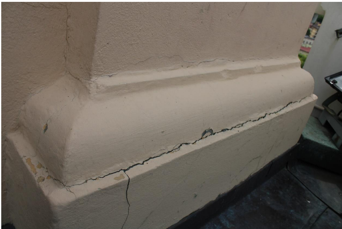
Fot. 33 Uszkodzenie cokołu ściany
