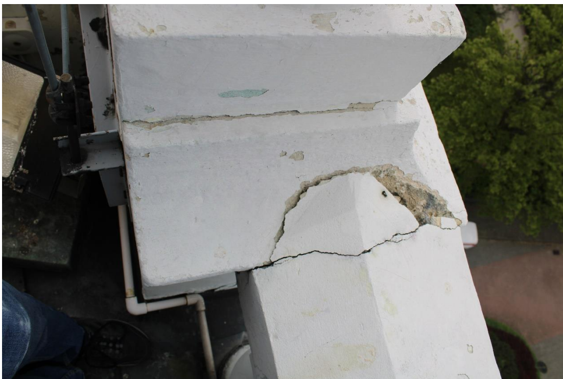
Fot. 29 Destrukcja górnej powierzchni poręczy na styku z elementem narożnym
