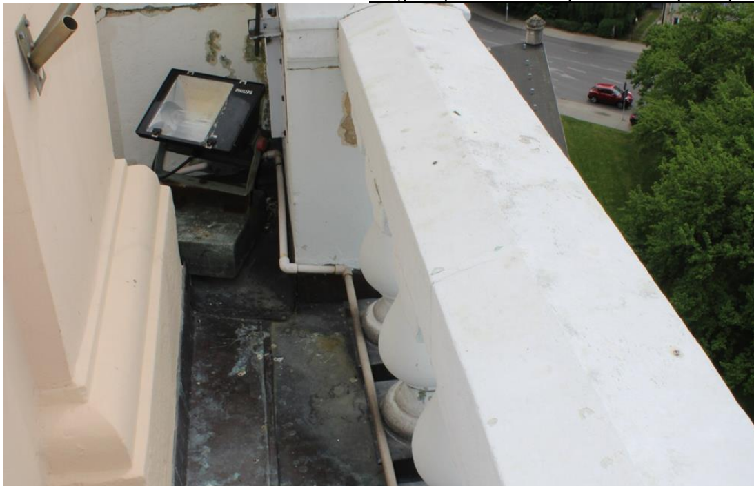
Fot. 31 Powierzchniowe pęknięcie poręczy od strony frontowej
